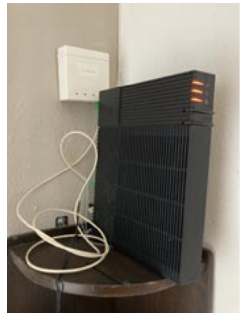
Box et branchement pour la fibre
